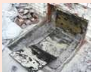
防水層切り取り
