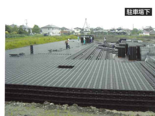
愛媛県内ショッピングセンター調整池(貯水量: 6,600m 3 )
