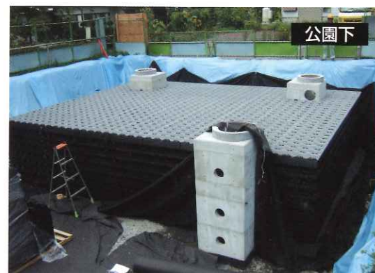
東京都内雨水利用貯水槽(貯水量: 100m 3 )
