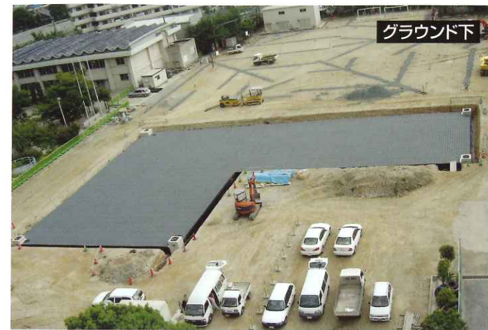
福岡県内小学校調整池(貯水量: 800m 3 )
