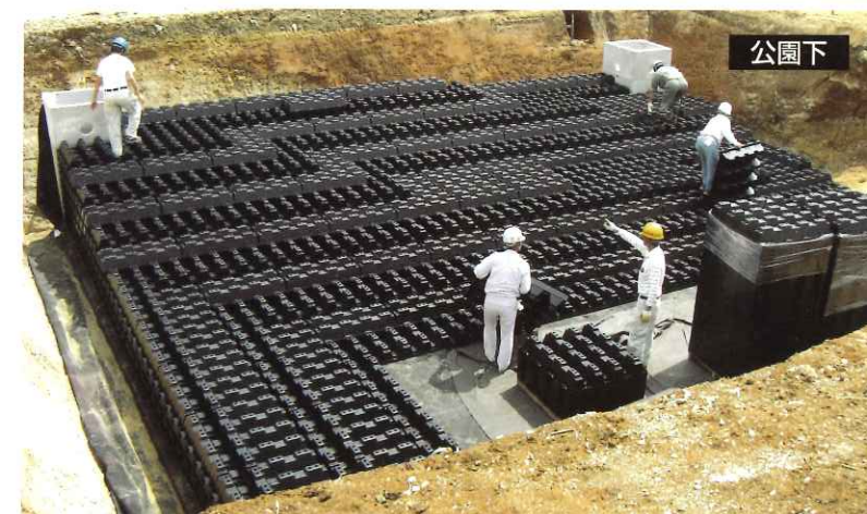
千葉県内宅地造成調整池(貯水量: 420m 3 )
